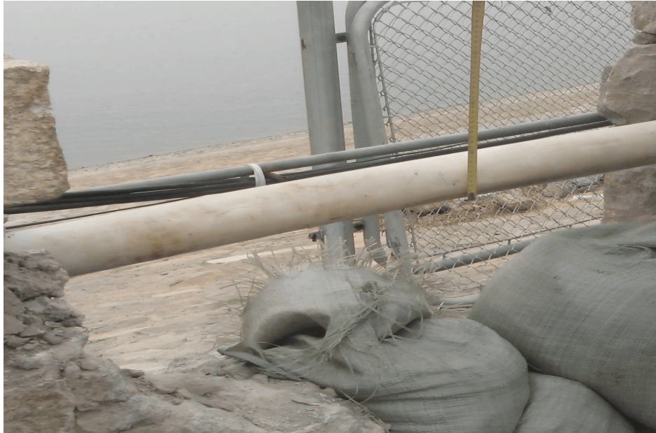
防浪墙内部电缆
