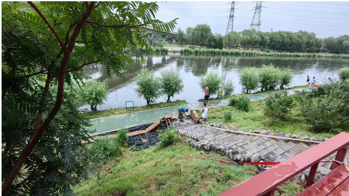
图 4.44 旧宫桥右岸塌陷
