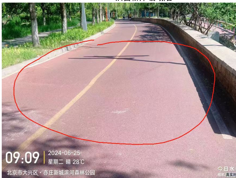
亦庄新城滨河森林公园巡河路损坏
