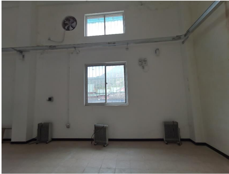
图2.1-13 泵房内部通风及采暖设施
