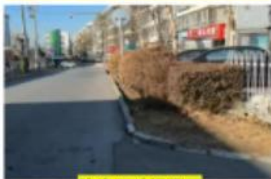
路缘石破损严重
