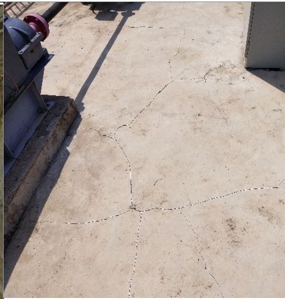
安河泄洪闸混凝土裂缝现状
