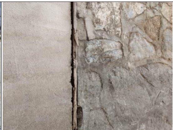
北台上进水闸伸缩缝现状
