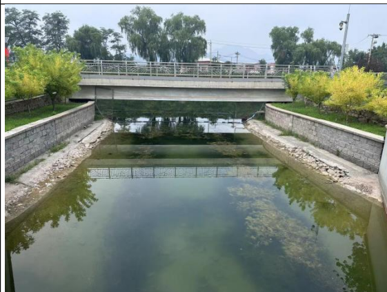
崔村泄洪闸闸前渠坡现状
