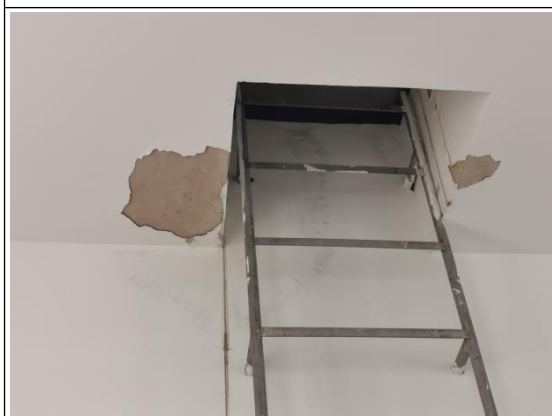
北台上倒虹吸出口闸天棚现状 (一)
