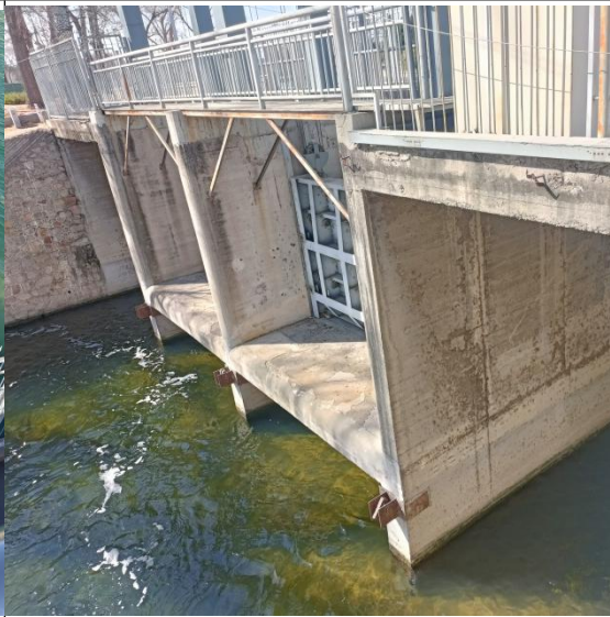
安河泄洪闸混凝土剥蚀现状
