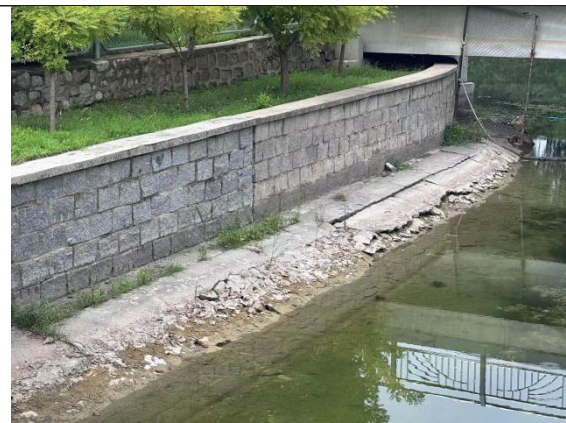
崔村泄洪闸闸前渠坡现状
