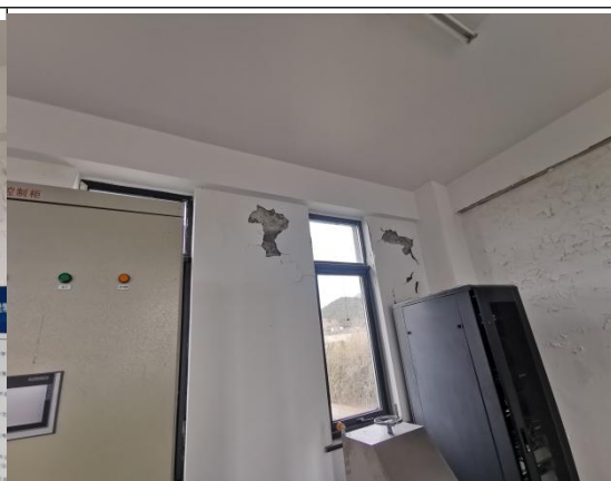
北台上倒虹吸出口闸内墙现状 (二)
