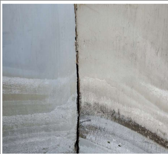
跌水节制闸伸缩缝现状
