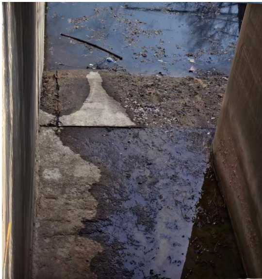
土城泄洪闸溢流面现状
