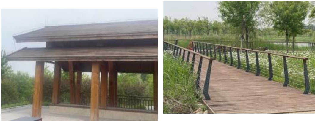
图 4-5 现状部分木质构筑物饰面开裂脱落
