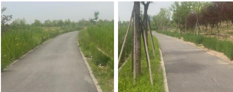
图 4-1 现状沥青混凝土路面
