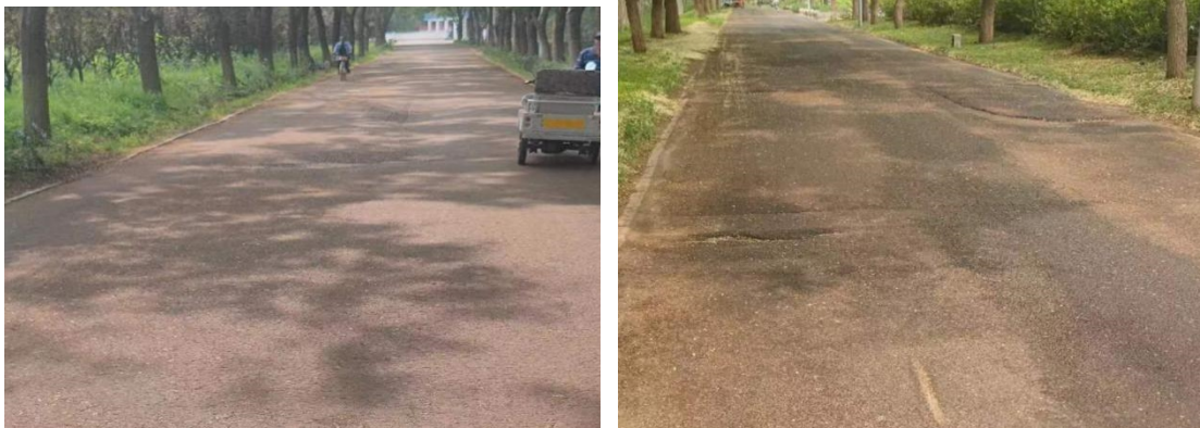
路面沉陷、坑槽以及局部波浪起伏严重
