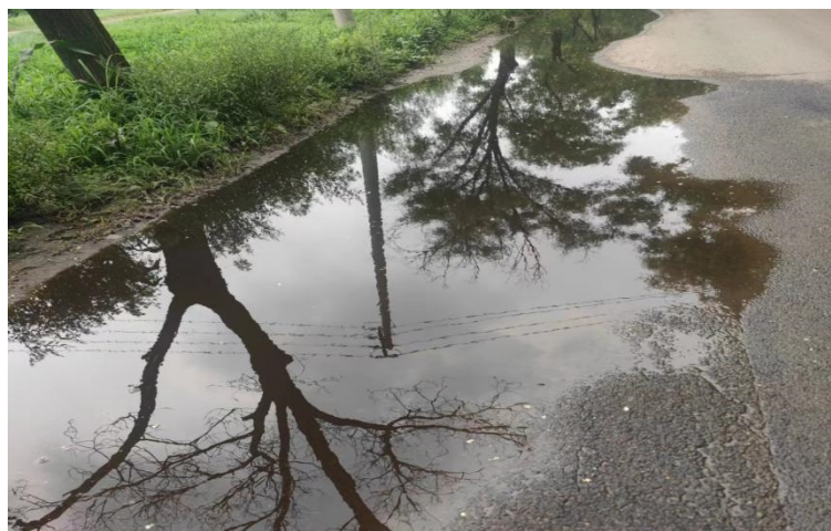
路面沉陷造成局部严重积水
