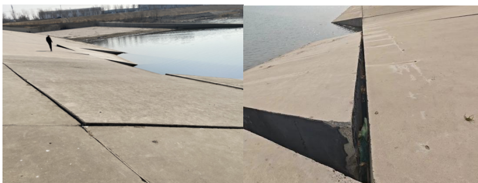
图 1-2 混凝土桥面冲毁
