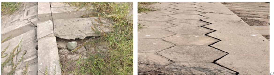
塌陷护坡现状照片←
