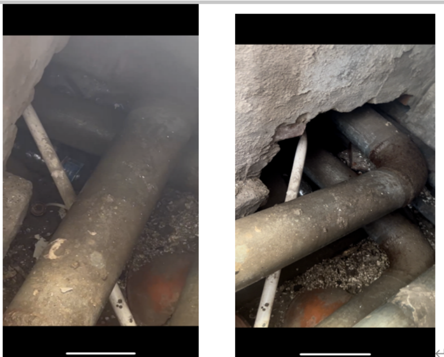
管路破损照片
